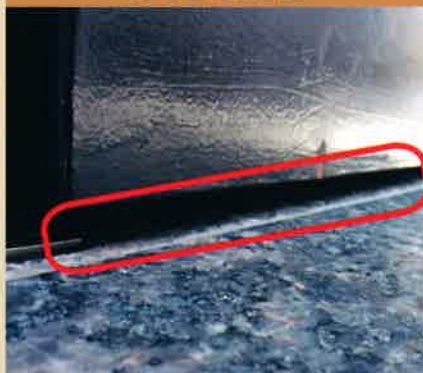
扉と床の隙間
